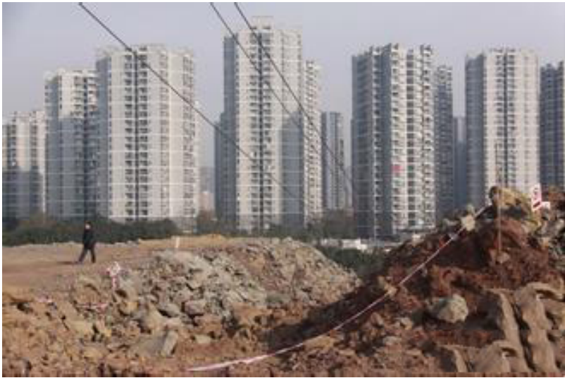
输电线路违章施工巡视
